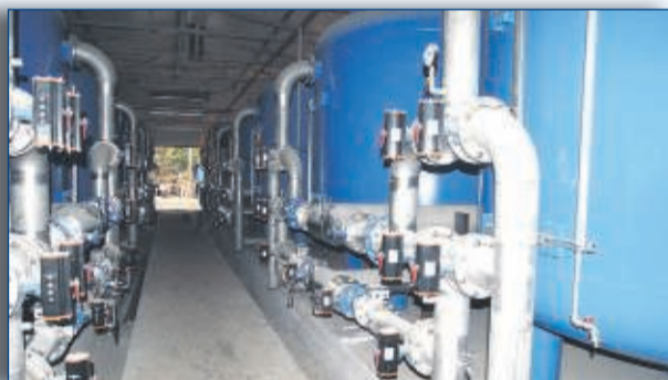
Nowe filtry w hali Stacji Uzdatniania Wody Bitwy pod Płowcami 2011 r.
